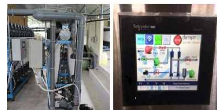
응에안성 수처리장 프로젝트 - 중공사 멤브레인 수처리 시스템 제어반 (디멤)
